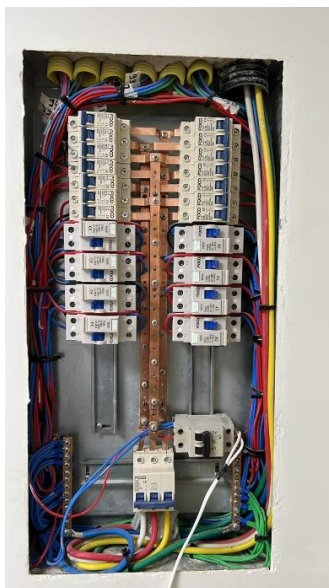
Figura 08 – Fotos De quadro de elétrica já instalado.
