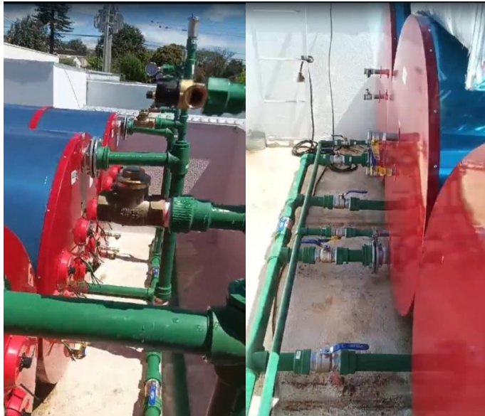
Figura 07 – Fotos do sistema de Água Quente – Conexões dos boilers
