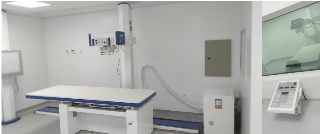
Figura 09 – Fotos da Sala de Raios x, com visor, porta e aparelho instalados.
