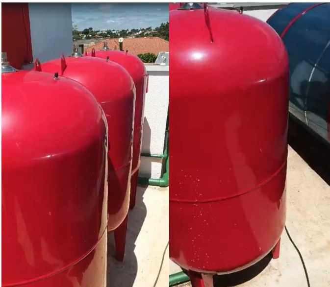
Figura 06 –Fotos do sistema de Água Quente – Vaso tanque de expansão.
